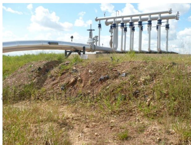
Foto 33. Conexión donde termina la Línea de Flujo 393. Unión con la Troncal 2.
