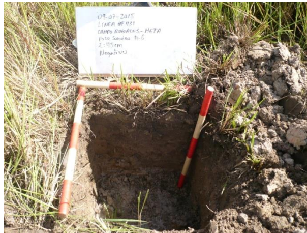
Foto 43. Pozo de sondeo No. 6 de la Línea de Flujo QF 431
