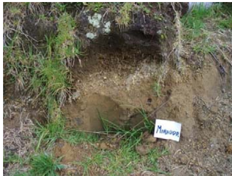
Fotografía 29. Talud de Mirador. Obsérvese capa de piroclastos que refleja la actividad volcánica.
