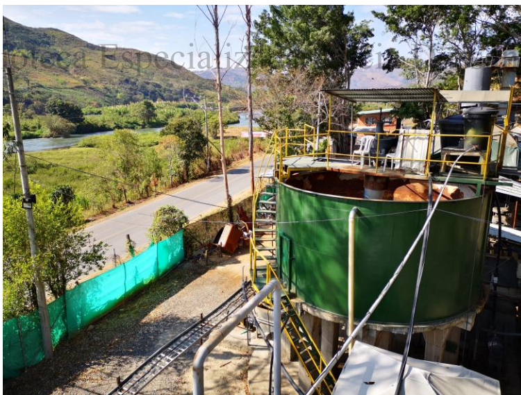
Foto 1. Tanque en sector norte de proceso de planta.
