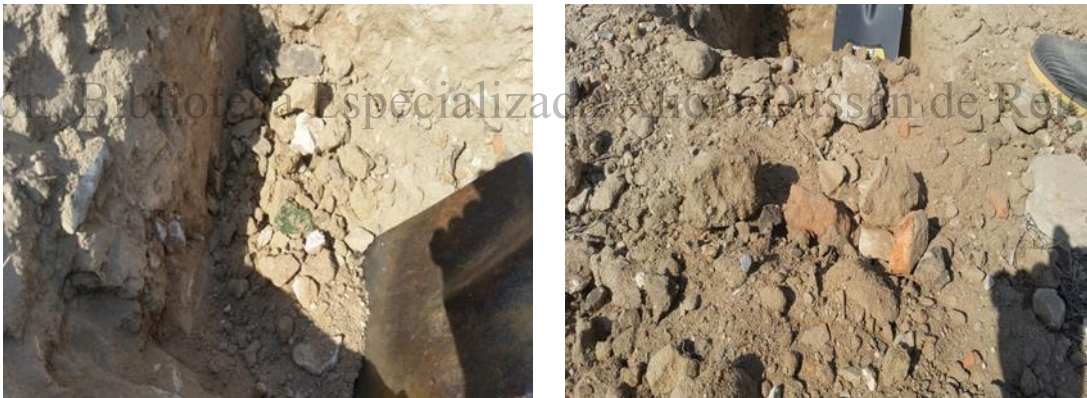
Fotografía 15 Detalle de desechos recientes encontrados en los rellenos en un pozo de sondeo de las pilas 1 a 18
