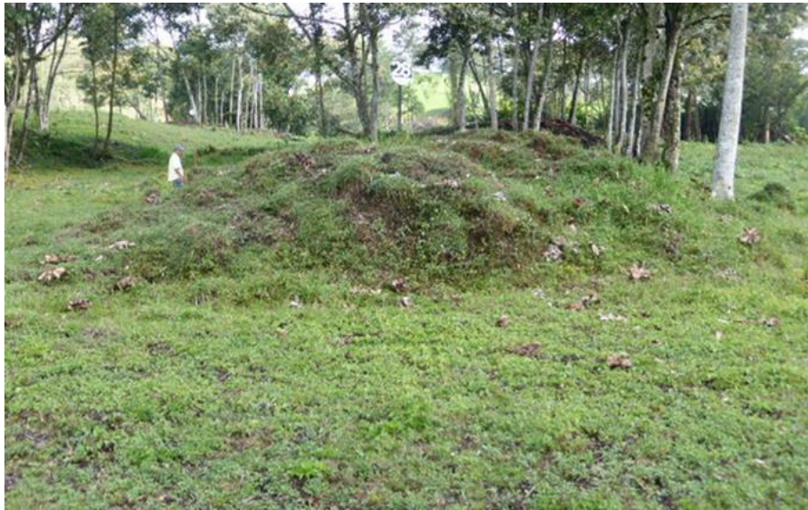
FOTO 5. MONTÍCULOS FORMADOS POR LOS SUELOS RETIRADOS PARA ADECUAR INVERNADEROS
