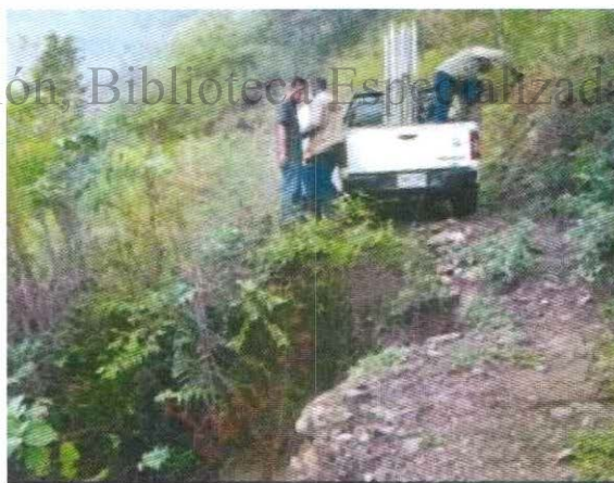
Fotografía 1.2 Pérdida de la banca en vía de acceso al predio.
