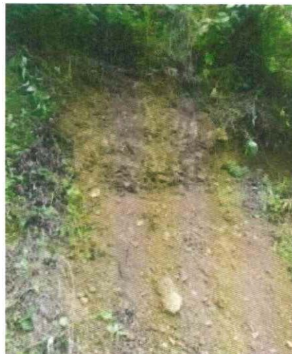
Fotografía 4.4 deslizamiento sobre la vertiente
