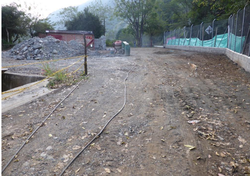
FOTO 15. ESTADO ACTUAL DE LA TERRAZA EN EL ÁREA 2
