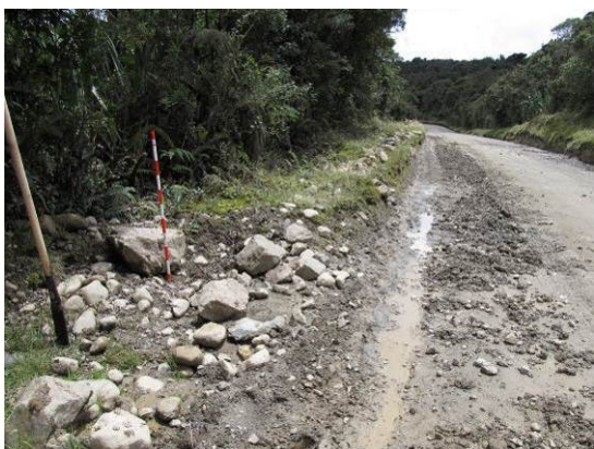
Fotografía 16. Evidencias de acumulaciones de material de relleno.
