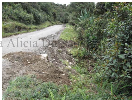
Fotografía 17. Evidencias de acumulaciones de material de relleno.
