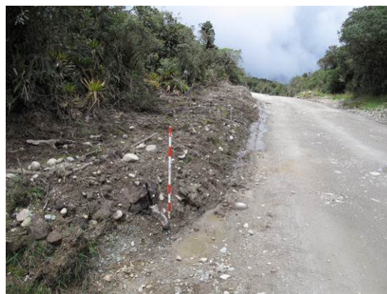
Fotografía 18. Evidencias de acumulaciones de material de relleno.
