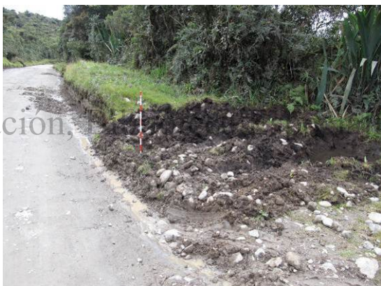
Fotografía 15. Evidencias de acumulaciones de material de relleno.
