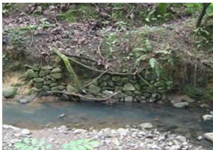
Foto 8. Evidencias de antiguos muros de contención de la quebrada La Sucia, lote Los Guayabos (Tabares, 2007)
