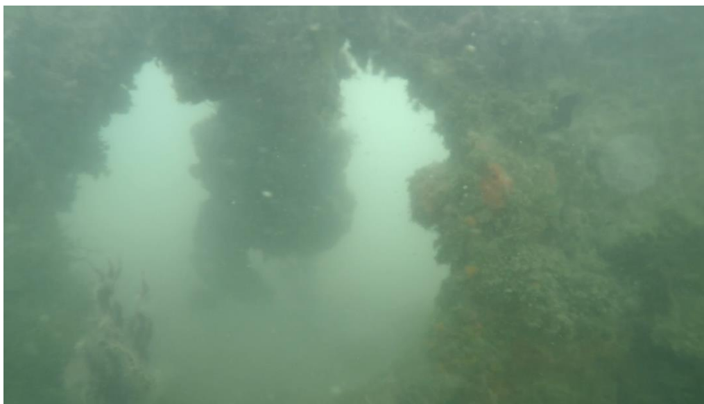
Detalle de abertura en casco con presencia de organismos
