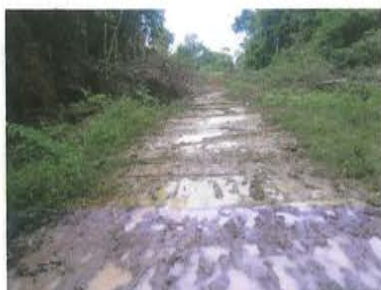
Fotografía 13 Encharcamientos en el camino
