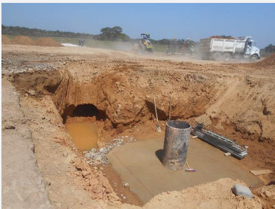
Fotografía 23. Formación de cárcava por erosión sub-superficial debido a flujo freático
