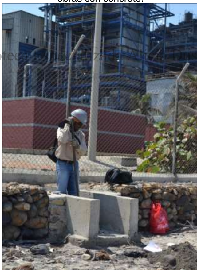
Figura 3. Obra de cemento en la malla. Debido a rellenos de suelos y obras en concreto no se pudo realizar pozos de sondeo tras la malla.
