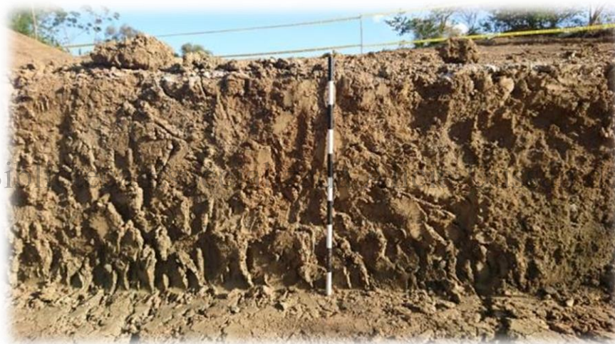
Fotografía 30. Km 0+940 perfil de excavación para box coulvert.
