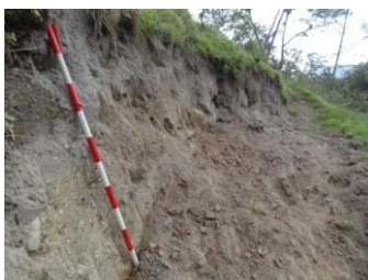
Figura 18 Talud expuesto en el camino de acceso a la UIA 15.
