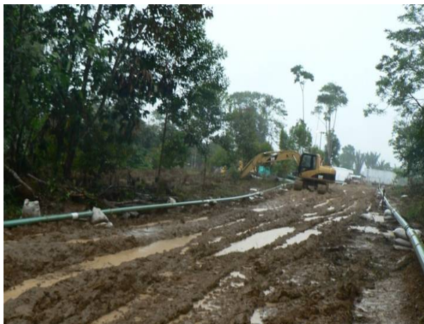
FOTO 2. INICIO DE LA LÍNEA, AL FONDO PLATAFORMA COSTAYACO 7.
