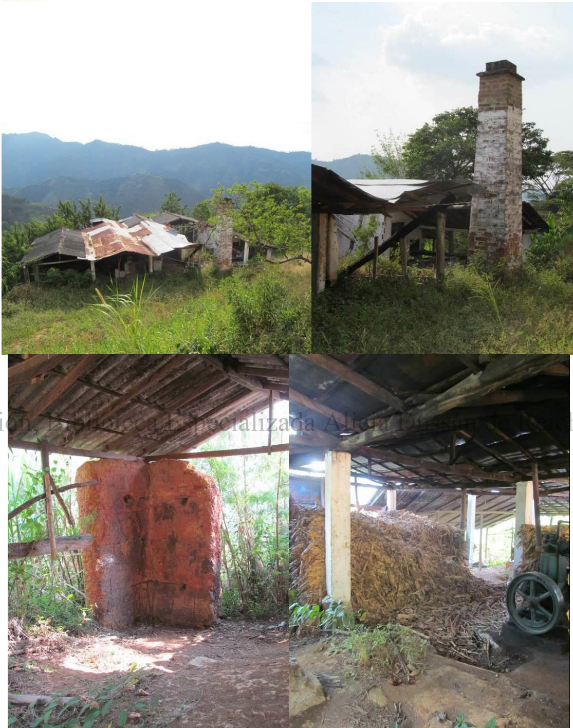
Fotos 19, 20, 21 y 22. Trapiche Carepalo aún en funcionamiento (2016), pero en muy mal estado.
