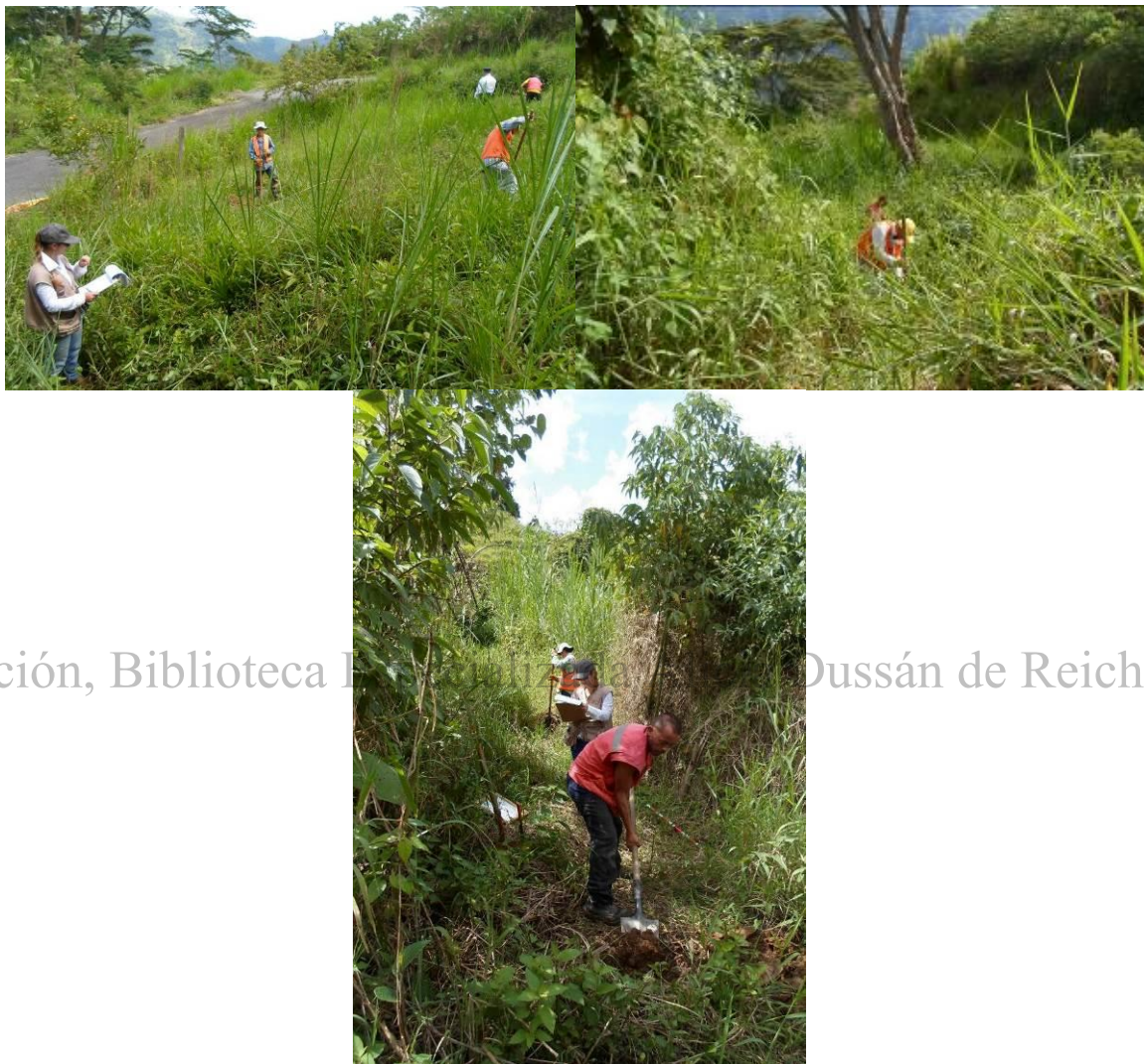
Fotos 64, 65 y 66. Desarrollo de los sondeos en el Sector 5 – Márgenes laterales de la vía de acceso con una cobertura de rastrojos bajos y altos.
