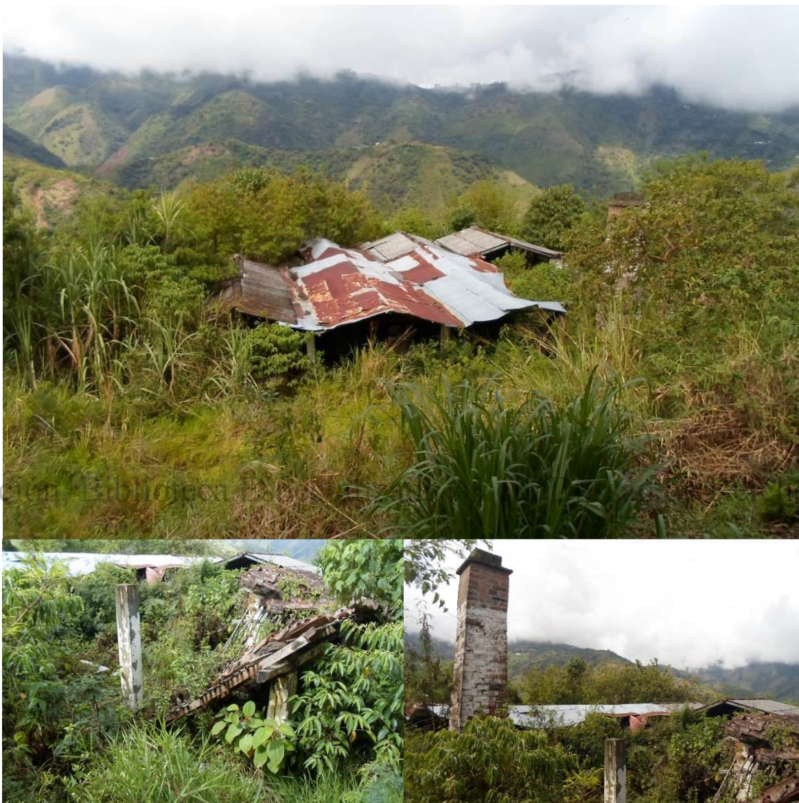
Fotos 31, 32 y 33. Vista de las instalaciones del trapiche desde la cota superior. Se aprecia el alto deterioro y abandono en que se encuentra en la actualidad, especialmente la cubierta y su estructura de madera, ya que no se está utilizando desde hace aproximadamente 2 años. (Fotos tomadas en abril de 2018) El rastrojo se está apoderando de toda la estructura.
