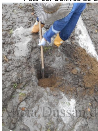
Foto 62. Realización de pozos de sondeo sobre superficie de fango
