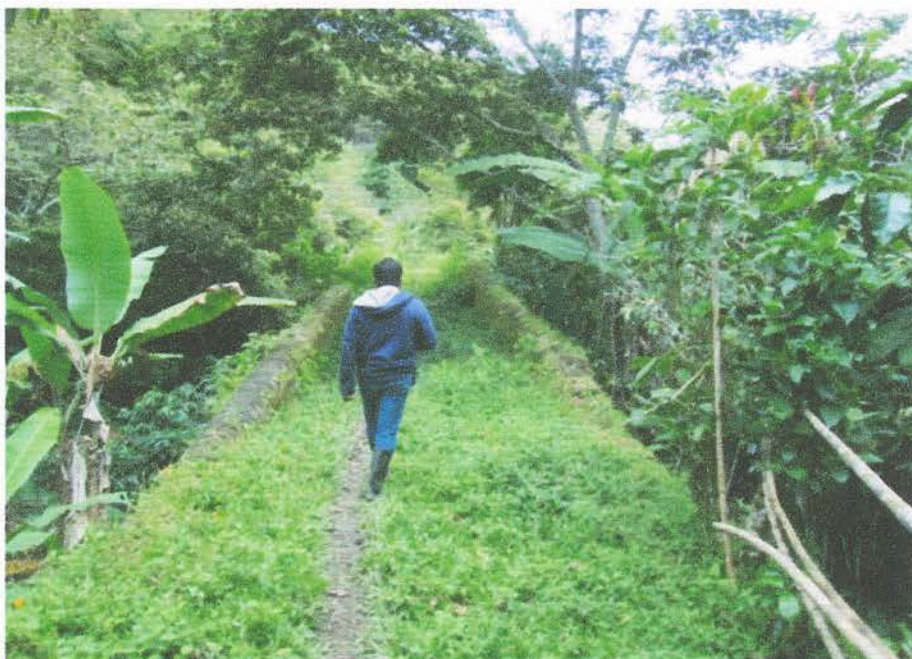
Foto 57. Vista superior y estado actual del puente.
