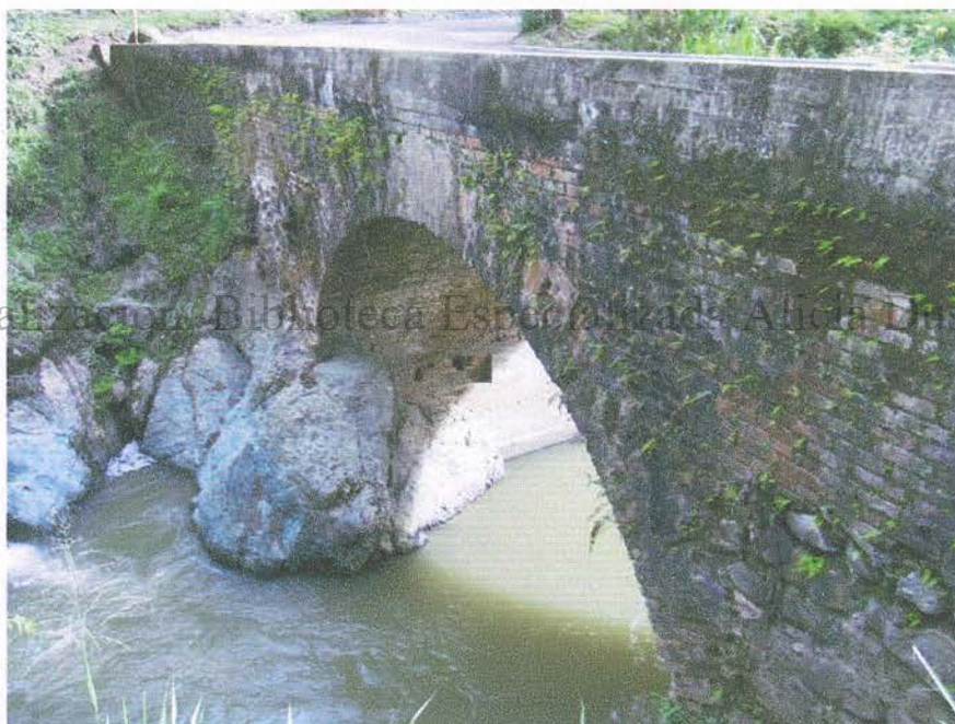
Foto 53. Vestigio del puente en mampostería sobre el río San Pedro. Coordenadas N 731030,6 – W 1034520,5.
