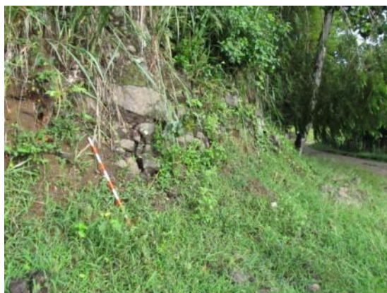
Foto 24. Áreas con evidentes procesos de acumulación de materiales foráneos para relleno.
