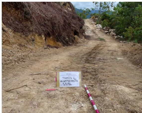
Fotografía 32 Vía cafetera sepultada
