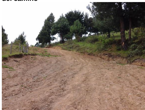
Fotografía 4-41 Tramo del camino afectado del camino
