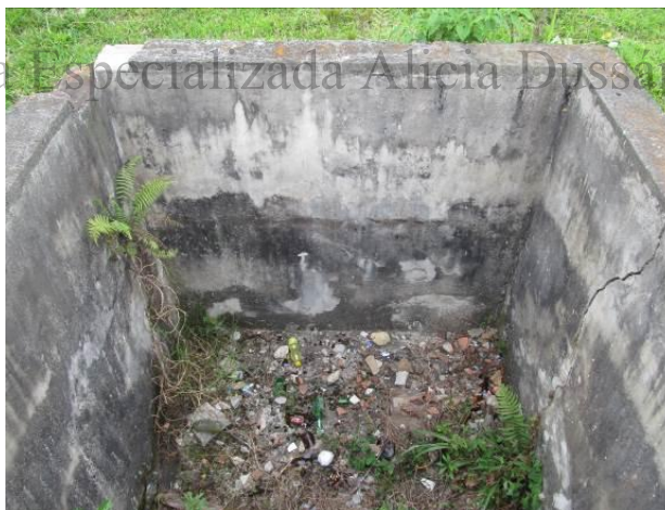
Foto 23. Tanque de agua abandonado.
