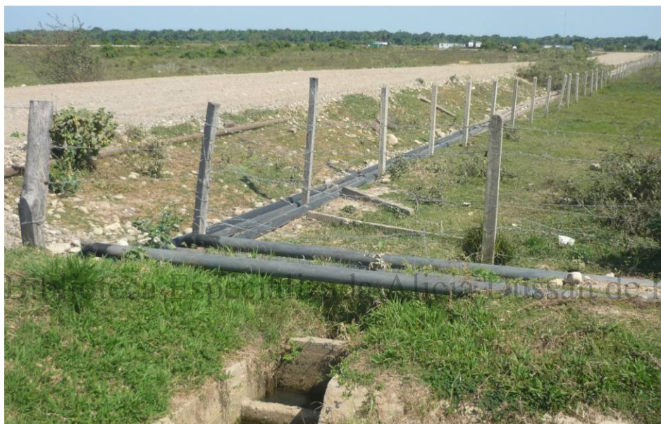
Foto N° 10. Líneas de Flujo ya existentes del bloque Cubiro, obsérvese la tubería expuesta que va paralela a las vías de acceso y por encima del nivel del suelo. Se nota también el terraplén sobre el cual va la vía. Este sistema constructivo es el que va ser implementado para la línea de flujo a construir.
