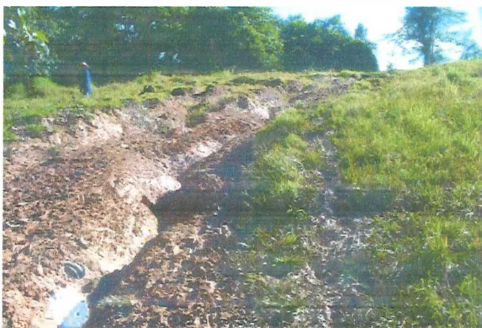
Fotografía 11. Áreas erosionadas propicias para la realización de inspecciones superficiales.
