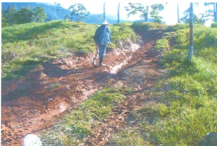
Fotografía 9. Áreas erosionadas propicias para la realización de inspecciones superficiales.
