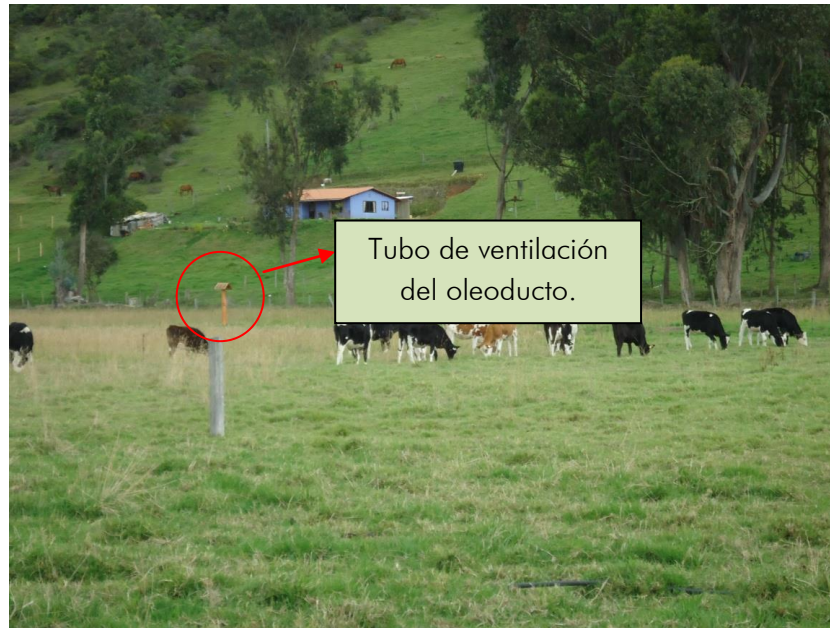
Fotografía 6-2 Tubo de ventilación por donde pasa el oleoducto de Ecopetrol
