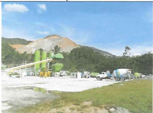
Fotografía 7. Planta Stetter, Silos y mando de planta
