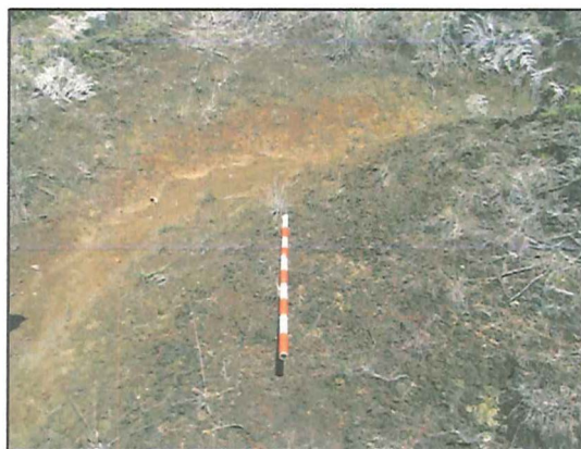
Foto 22. Erosión superficial sector vía
