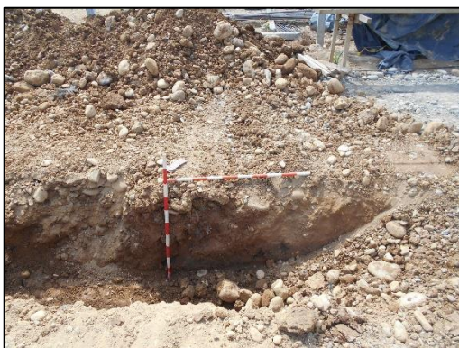
Fotografía 85 Detalle de perfil para tendido de cableado eléctrico. Vista al norte. Coordenadas E:1046429,10 N:916642,44.
