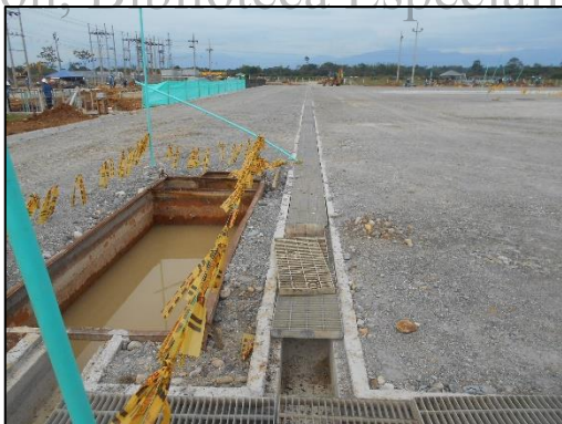
Fotografía 48 Skimmer 2 en la convergencia de los tramos sur y este de las cunetas de aguas aceitosas, vista oeste. Detalle de construcción sobre relleno. E:1046504,28 N:916692,04
