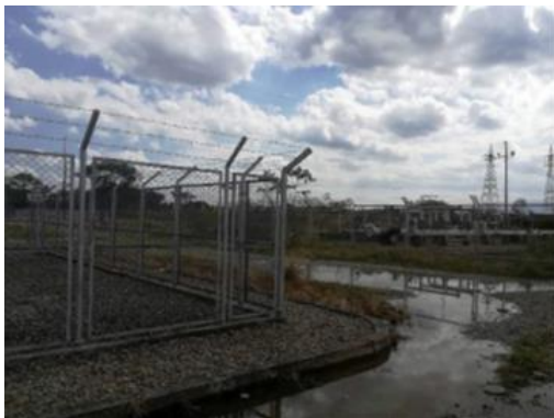
Fotografía 1 Instalaciones del existente Clúster 19.
