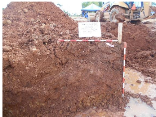
Fotografía 78 Detalle de ampliación de ductos para Pull point A, vista al norte. Coordenadas E:1046458,13 N:916666,91
