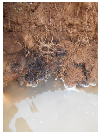
Fotografía 106 Tercera irregularidad, observada en excavación de cunetas pluviales, vista norte. Coordenadas E:1046416,53 N:916822,68.
