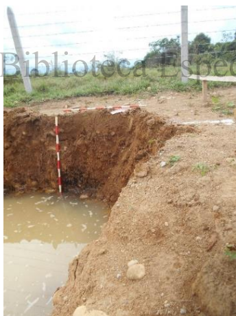
Fotografía 105 Tercera irregularidad, excavación esquina noroeste, vista oeste. E:1046416,53 N:916822,68
