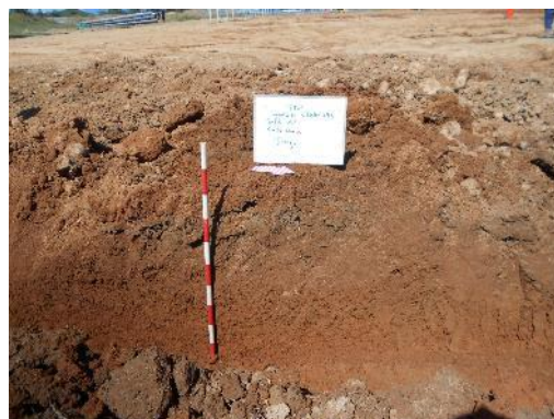
Fotografía 17. Ejemplo de zanja en malla a tierra, sur. Coordenadas E: 1046427,11 N: 916648,73.
