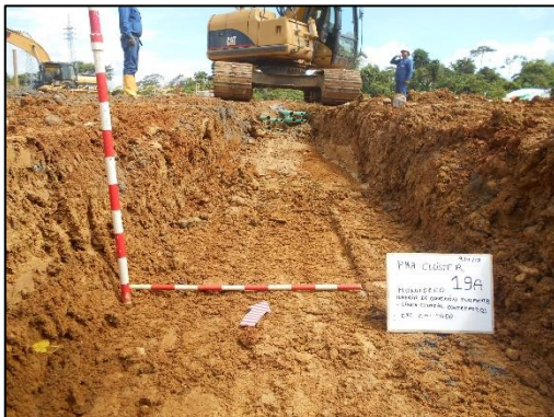
Fotografía 69 Banco de ductos, línea central. Coordenadas E:1046438,59 N:916681,40.
