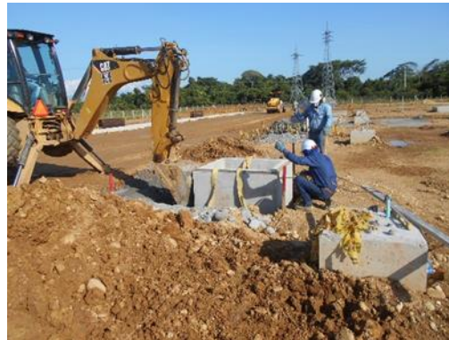
Fotografía 33 Caja de bombeo correspondiente al contrapozo no. 1, vista al noroeste. Coordenadas E:1046473,11 N:916705,69
