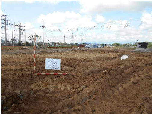
Fotografía 113 Área cercana al pozo 29, detalle de erosión del suelo. Coordenadas E:1046399,15 N:916678,35
