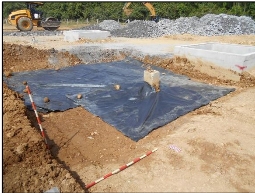
Fotografía 81 Aislamiento para caja de control, zona centro. Vista al noreste. Coordenadas E:1046475,50 N:916727,06
