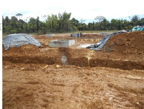
Fotografía 74 Banco de ductos, línea central. Bifurcación hacia el contrapozo no.8. Vista al este. Coordenadas E:1046441,84 N:916719,65.
