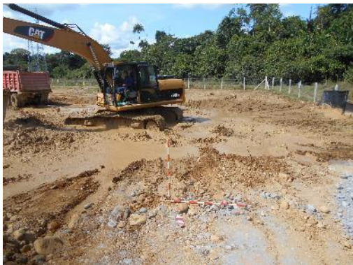
Fotografía 10 Desnivel erosionado por corrientes intermitentes en proceso de relleno, esquina noreste. Coordenadas E: 1046420,06 N: 916813,77
