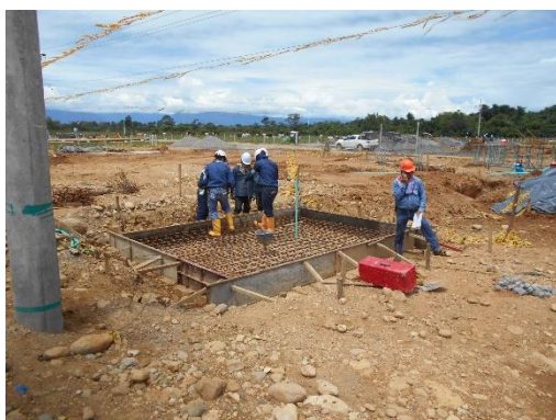
Fotografía 83 Placa para Transformador SDT-2, vista al oeste. Coordenadas E:1046443,76 N:916651,90.
