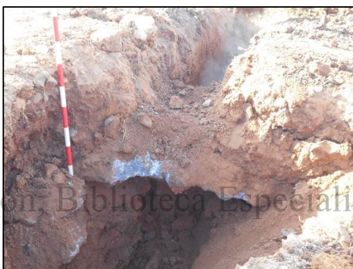
Fotografía 107 Detalle de placa de concreto en zona sur, vista norte. Coordenadas E: 1046408,05 N: 916655,66.
