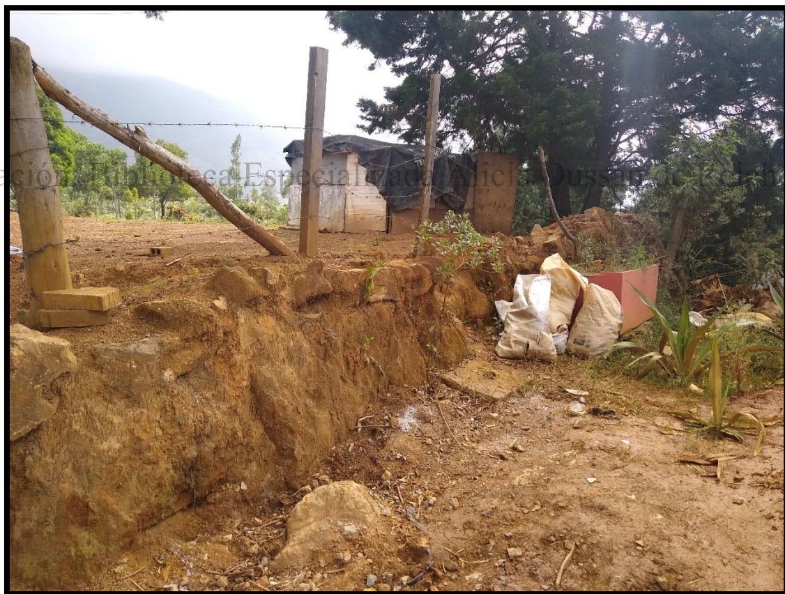
Foto 30. Detalle del estado de conservación del vallado en Piedra (Rasgo 1).
