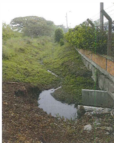
FOTO 3. CAÑO SECUNDARIO VÍA FERREA
