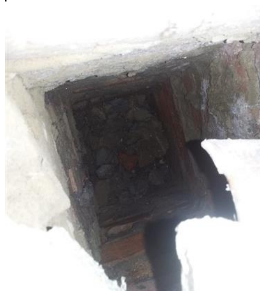
Figura 41. Detalle de la caja colectora de aguas negras. Carrera 9 entre calles 12 y 12B, costado occidental.
