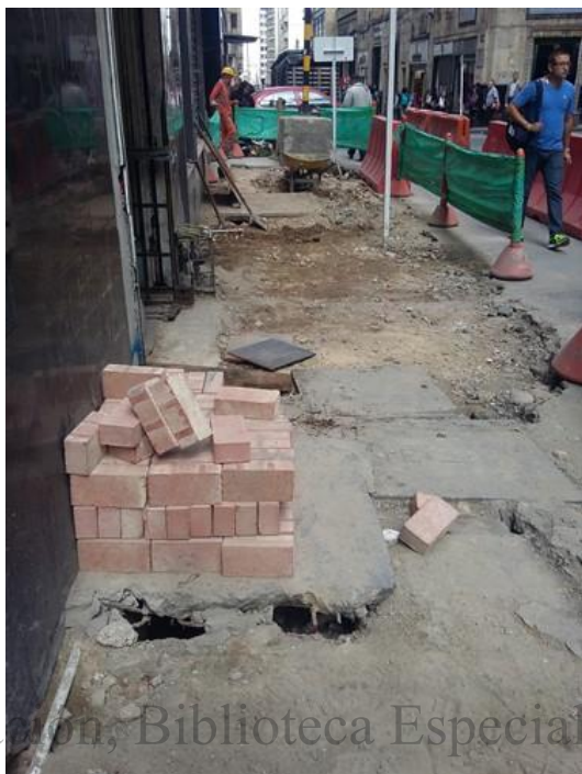
Figura 48. Cajas colectoras sobre el piso removido en la calle 12 b entre carreras 8a y 9 costado sur.
