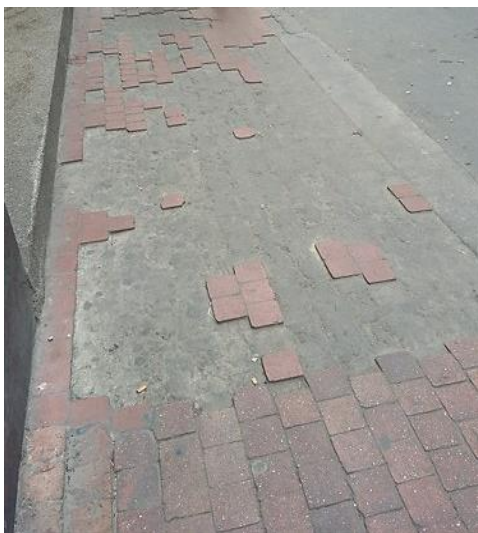
Figura 45. Estado inicial del andén sur de la Calle 13 (12b) entre carreras 8a y 9.
