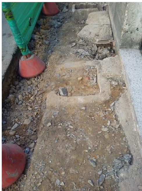
Figura 42. Relleno bajo el adoquín en la carrera 9 entre calles 12 y 12B, costado occidental
