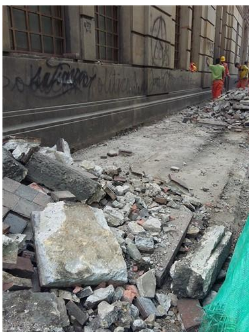
Figura 18. Placa de concreto bajo el adoquín. Carrera 8 entre Av. Jiménez y Calle 12C, costado oriental.
