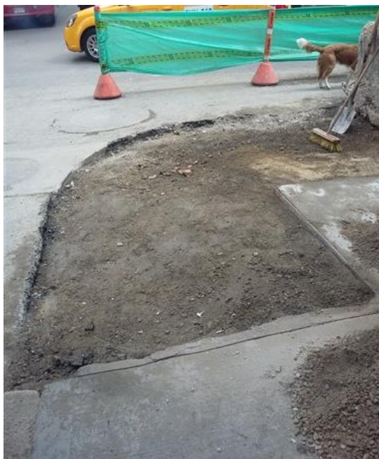
Figura 46. Rompimiento de las esquinas del andén de la calle 12b entre carreras 8a y 9, costado sur.
