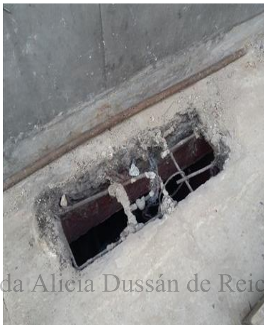
Figura 32. Orificio que determinó la existencia de construcciones subterráneas. Carrera 9 entre calle 12 y 12B, costado oriental.
