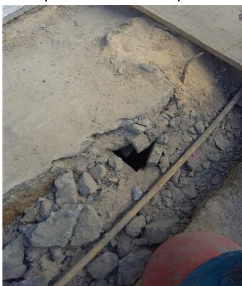
Figura 40. Orificio que determina la presencia de una caja colectora de aguas negras. Carrera 9 entre calles 12 y 12B, costado occidental
