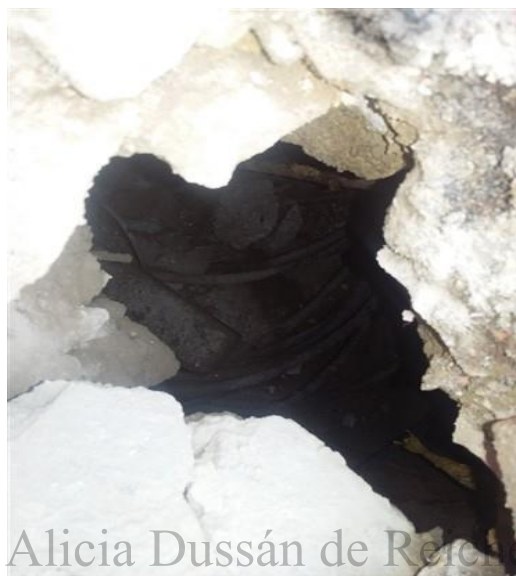
Figura 36. Orificio que muestra una caja de cableado. Esquina de la Carrera 9 con calle 12 costado oriental.
