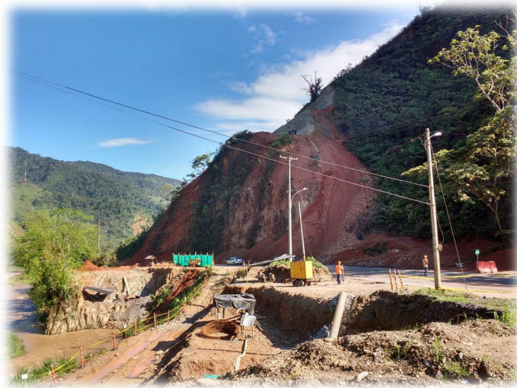
Fotografía 5. Ejemplo del estado inicial de las obras en el puente Paraguas registrado durante la primera visita.
