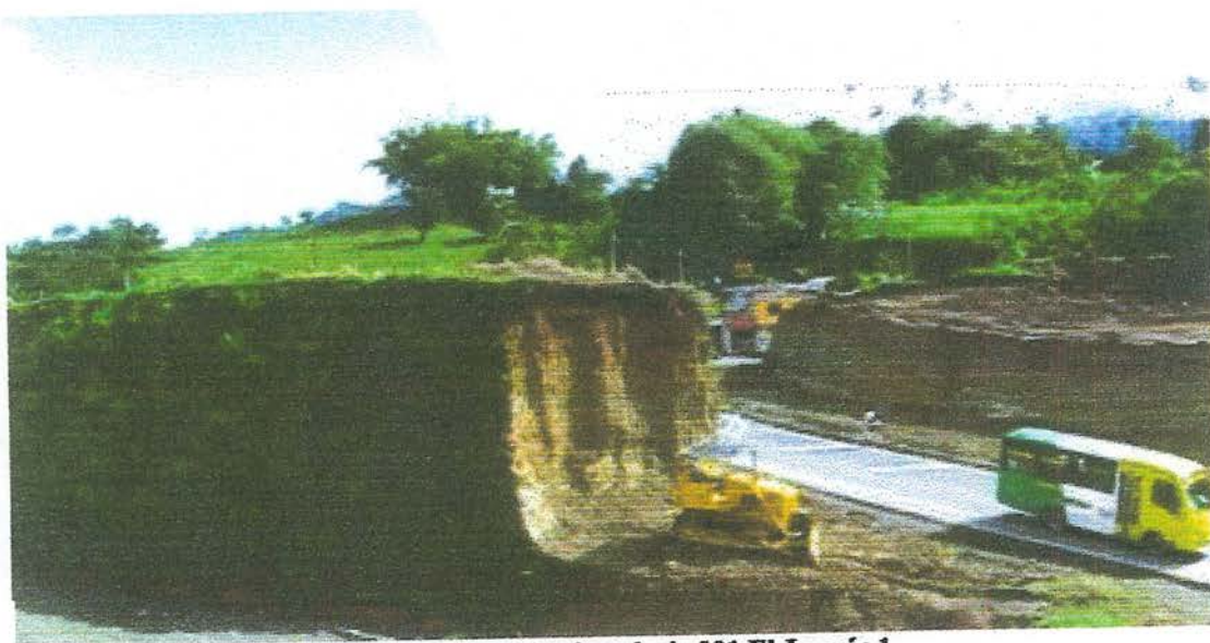
Foto 241. Talud oriental, eje 001 El Jazmín 1
