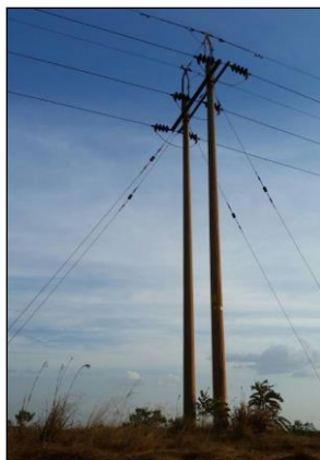
Fotografía 1 Ejemplo estructura Tipo H, actualmente en funcionamiento en Campo Rubiales
