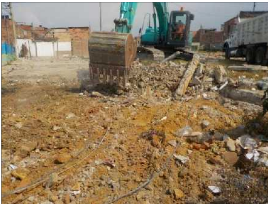
Foto 3 – Excavación, exposición de la capa de recebo, presencia de varillas de hierro
