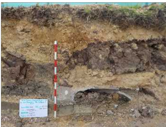
Foto 51. Exposición de tubería sin uso en el K0+480 en pared izquierda de costado derecho
