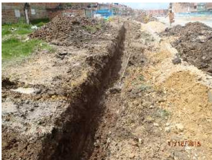
Foto 104. Excavación K1+010 costado derecho borde externo.
