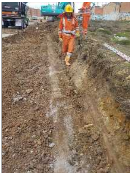
Foto 67. Presencia de tubería sin uso. Profundidad 70 cms
