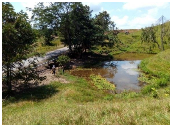
Fotografía 26 Carretera y zona anegadiza PS 167. E 1012854,7 N 1260216,4
