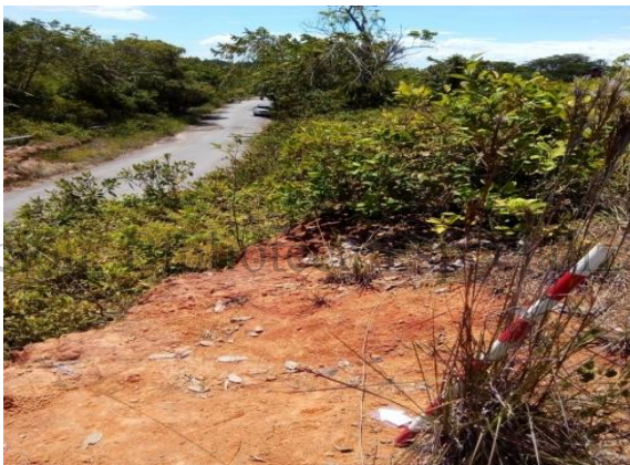
Fotografía 27 Área erosionada colindante con carretera. Ps 680 Línea Sur Peñas Blancas E 1014721,0 N 1262439,9
