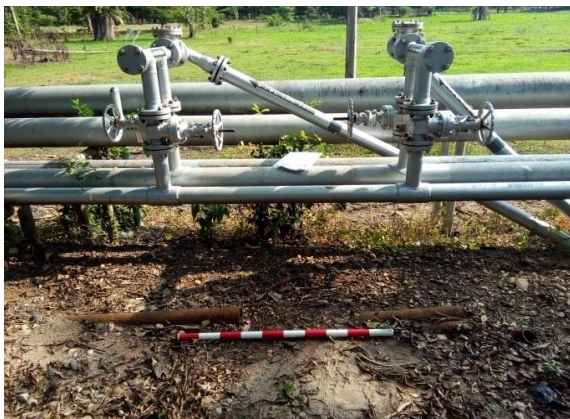
Fotografía 103 Tuberías activas y otras líneas de flujo en desuso, asociadas al PS 1534, en llanura aluvial. E 1017830,3 N 1269685,5
