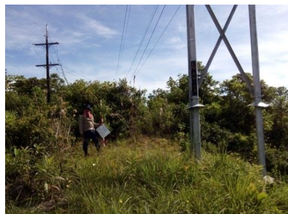
Fotografía 24 Infraestructura eléctrica, postes de líneas eléctricas. PS 932. E 1015006,0 N 1263834,5
