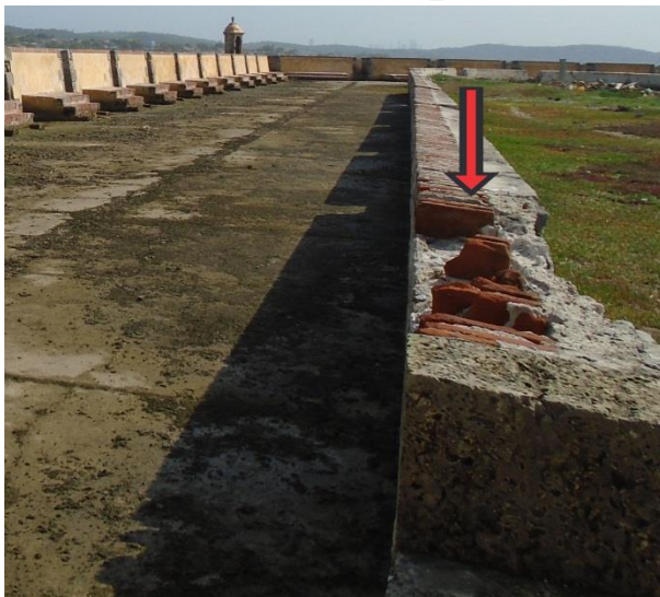
Figura 30. Desprendimiento de material pétreo y de ladrillo.
