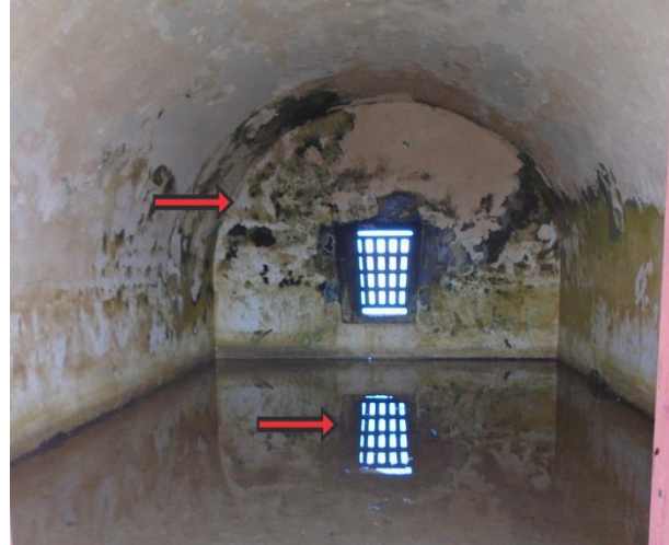
Figura 33. Bodega inferior inundada y con grandes áreas de moho en las paredes.
