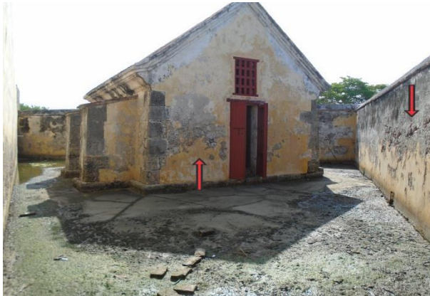
Figura 28. Desprendimiento del estuco en la edificación y fisuras activas en la pared de la derecha.
