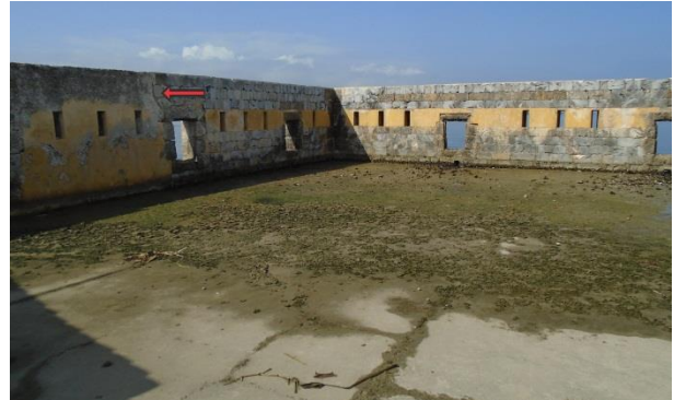
Figura 29. Desprendimiento del estuco.
