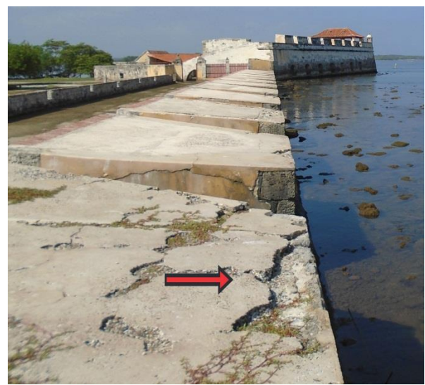
Figura 31. Erosión en los merlones de la estructura lateral "a flor de agua".
