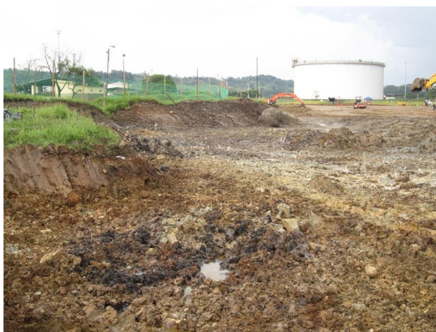
Foto 19 Corte y excavación sector suroriental del área la coloración negra es por contaminación de crudo.
