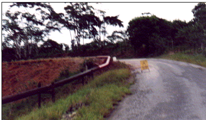
Foto 10 Tramo del oleoducto, recién dinamitado y reconstruido entre La Dorada/San Miguel y La Hormiga. Dic. 2003
