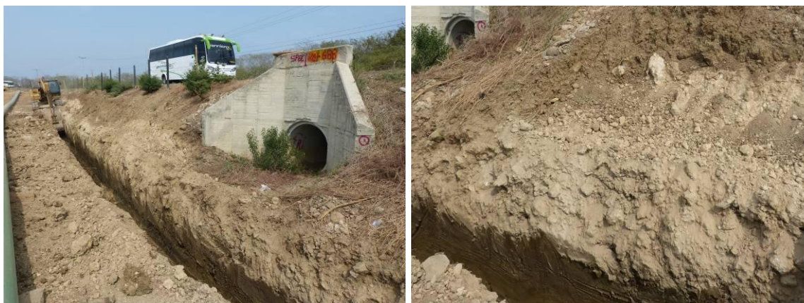
Foto 54. Detalle de zanjado, nótese el alto nivel de material de relleno en cercanía a alcantarilla de la vía.
