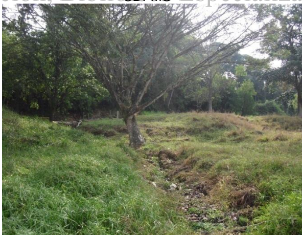
Foto 17. Canal de drenaje provocando erosión
