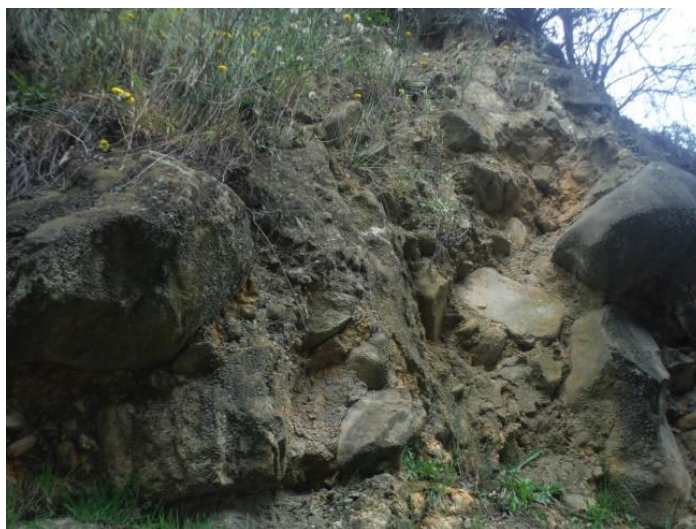
Foto 8 Ladera intervenida por construcción de la vía
