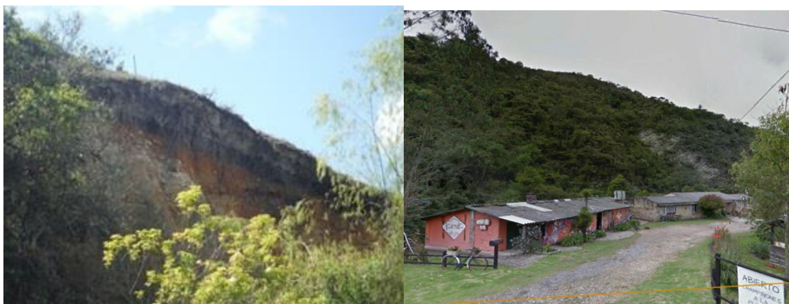
Foto 3 Foto 4 Talud expuesto por intervención moderna y zona de ladera de montaña
