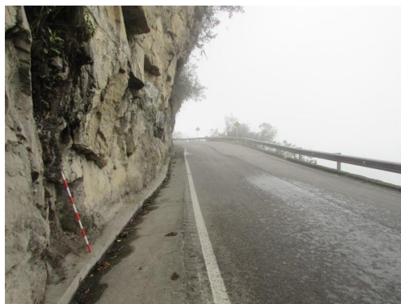
Foto 38 Peña vertical en la vía
