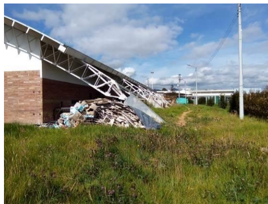
Fotografía 31. Sector norte del auditorio. Nótese acumulación de escombros en el área
