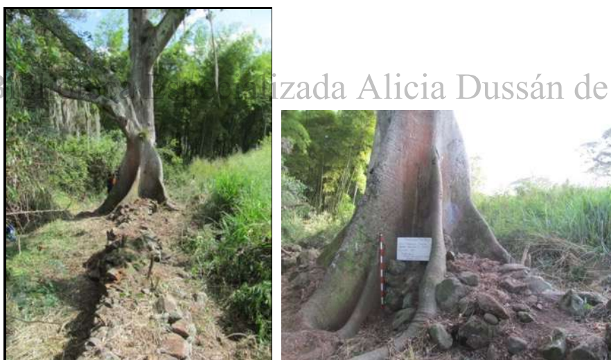
Fotos 112 y 113 Muro 2 – vista longitudinal, al extremo sur árbol de ceiba que creció encima del muro después de su construcción, desplazando las piedras.
