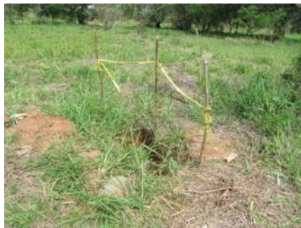
Foto 84 Estado inicial de la depresión encontrada en las Pistas de Niquía
