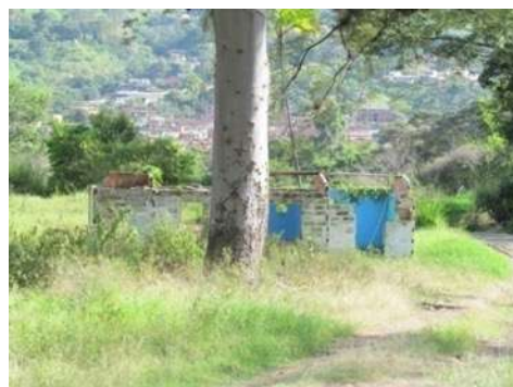
Foto 38 Vivienda reciente en ruinas ubicada sobre la terraza aluvial.
