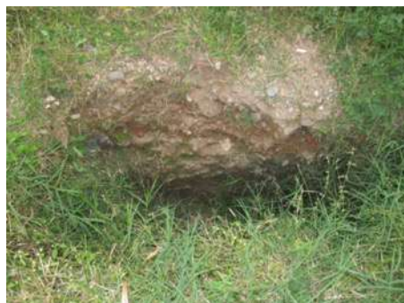
Foto 73 Perfil de suelos donde se aprecia una amplia acumulación de escombros en el sector de la quebrada La Seca
