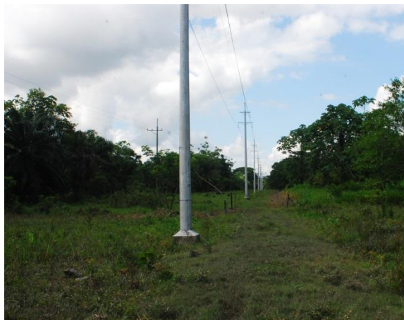
Fotografía 5-19 Servidumbre línea eléctrica
