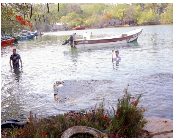
Fotografía K: Lado oriental del proyecto El Cove, se observa parte de las placas derrumbadas del muelle.
