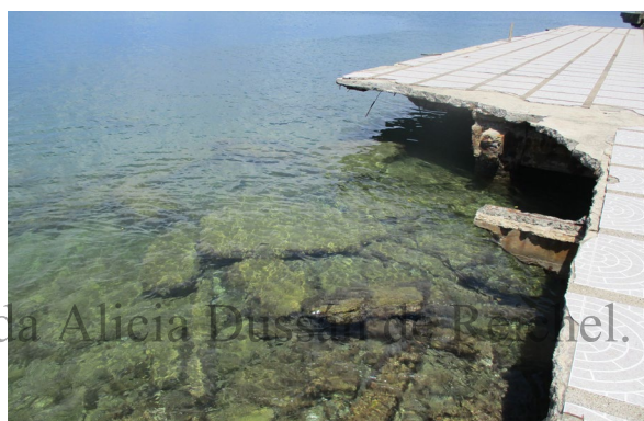
Fotografía J: Detalle sector derrumbado del muelle actual.
