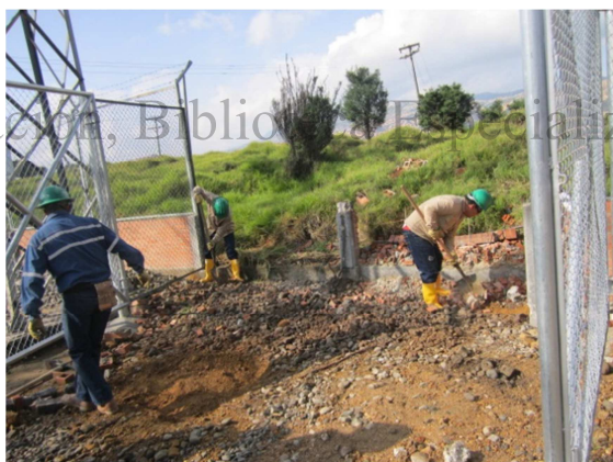
Fotografía 4-11 Cerramiento perimetral Fuente: Monitoreo arqueológico SVC Tunal. 2014
