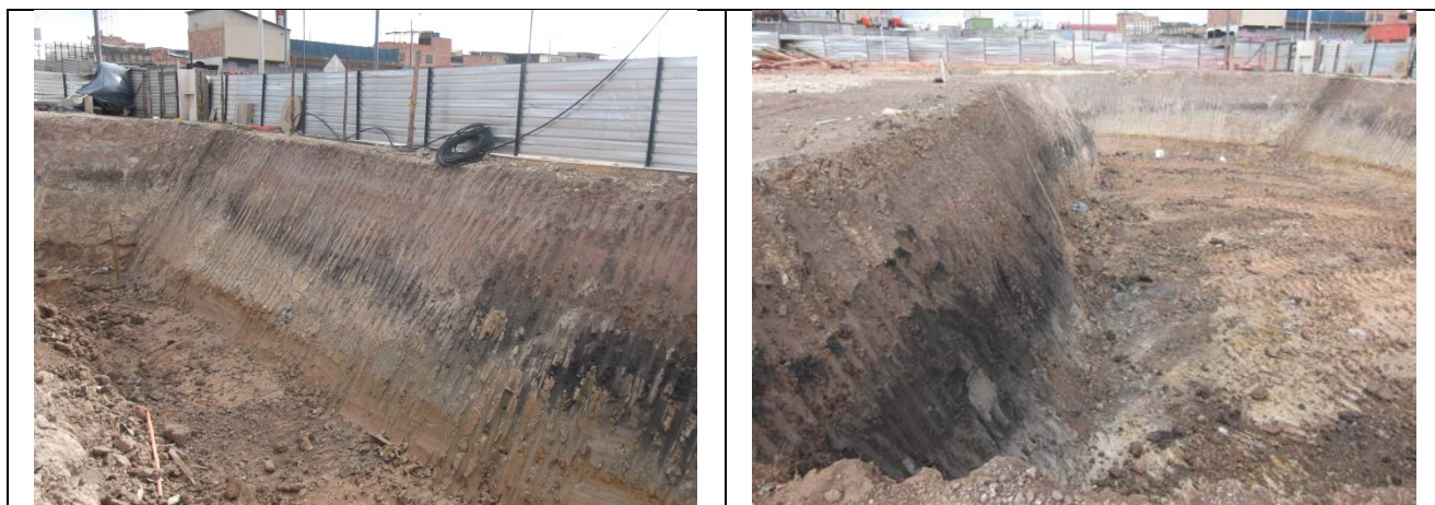
Fotos 39 y 40: Perfil zona de monitoreo, donde se observa la capa superficial de material de concreto y arcillas turbosas (color negro) a 3 metros, producto de la conversión de materia orgánica en carbón.
