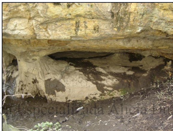
Fotografía 31. Proceso de formación de caverna e inestabilidad del bloque de roca superior
