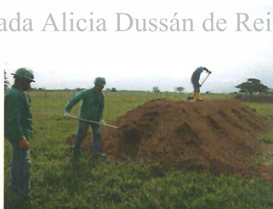
Fotografía 4 Revisión de material de descapote sin vibro compactar
